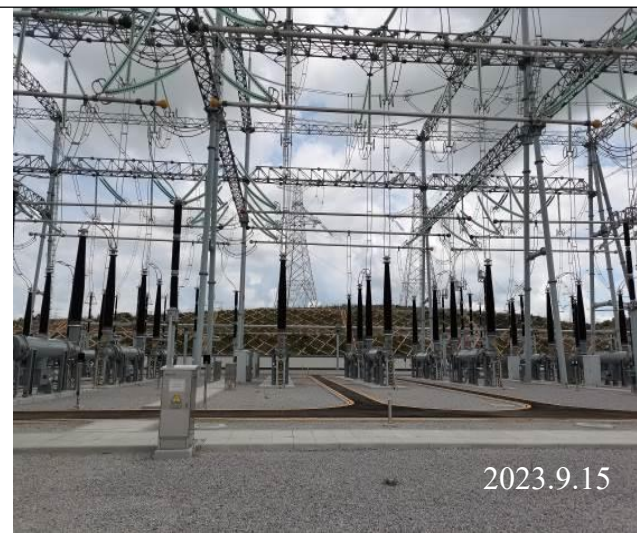
线路终点（云海风电场变电站）
