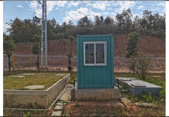
照片 4 污水处理站
