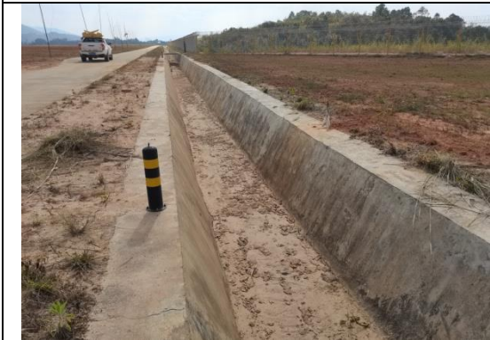
照片 21 航站区排水设施
