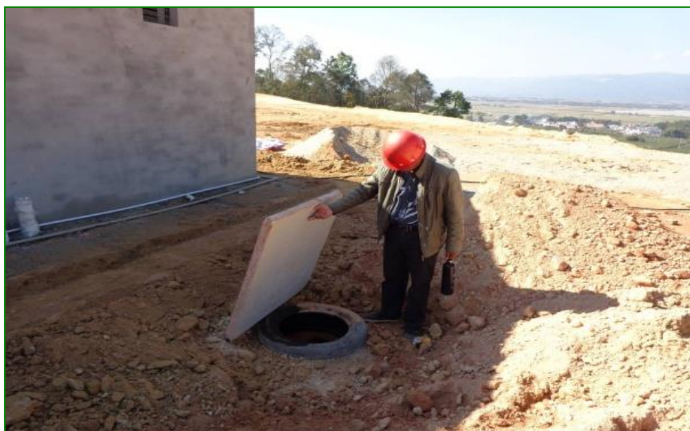
图 6.1-1 项目施工期废水处理措施（化粪池）
